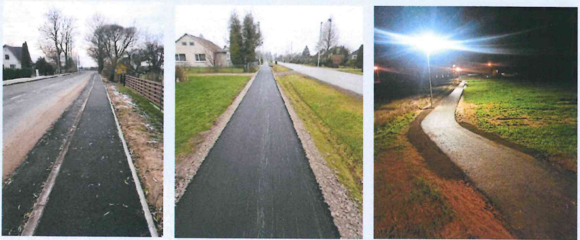
Laižuvos mstl. Dariaus ir Girėno g. pėsčiųjų tako atkarpos remontas (kairėje) ir Auksūdžio k. Taikos g. pėsčiųjų tako remontas (viduryje) ir Balėnų k. įrengtas pėsčiųjų – dviračių takas (dešinėje)
