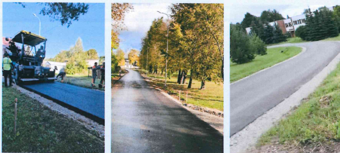
Pikelių mstl. Kaubrių g. kapitalinis remontas (kairėje ir viduryje) ir Laižuvos mstl. Mokyklos g. asfaltbetonio dangos paprastas remontas (dešinėje)
